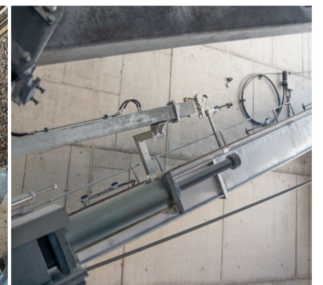
Entleerungsmechanik in der Talstation.
