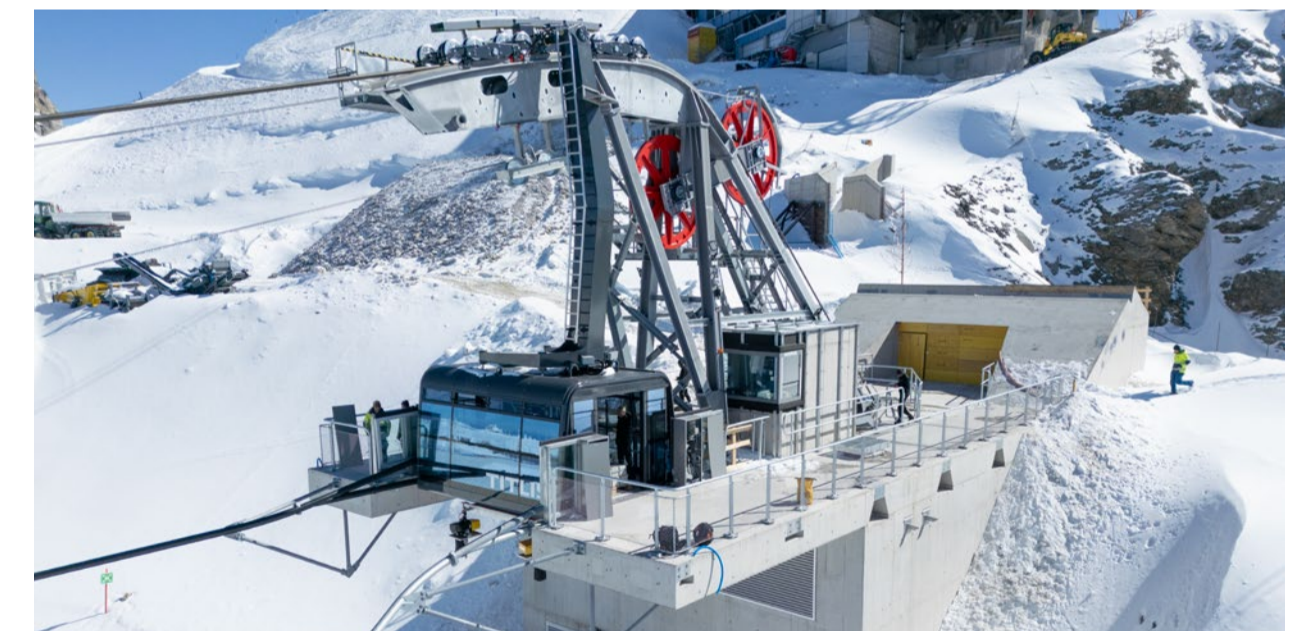
Bergstation auf 2.992 m Seehöhe, mit dem bereits vorbereiteten Zugang zum künftigen Verbindungstunnel.
