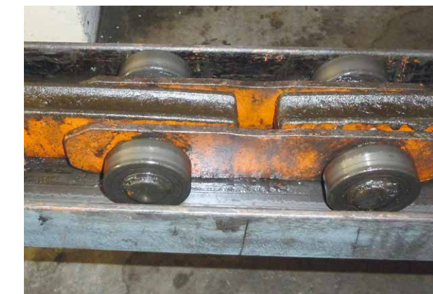
Die Rollenkette zur Ablenkung der Tragseile bei der Härmelekopfbahn vor deren umfassenden Revision.
