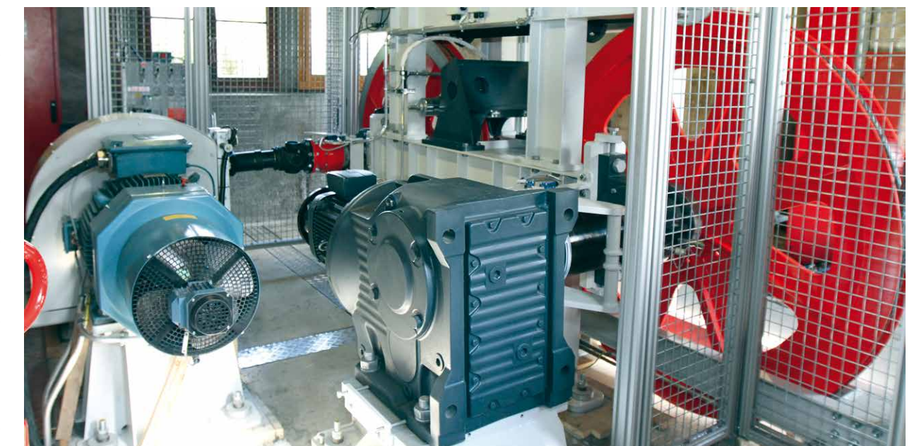
Sorgt für neuen Schwung: Der neue Antrieb der Luftseilbahn Turtmann-Oberems mit den beiden Antriebsscheiben.
